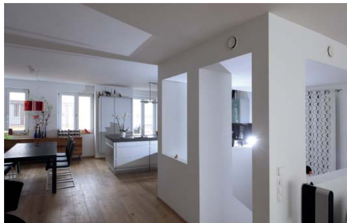
Raumbildender Ausbau mit Be- und Entlüftungsaggregat
