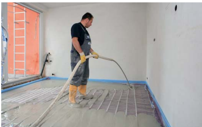
Fußbodenheizung im Neubaubereich
